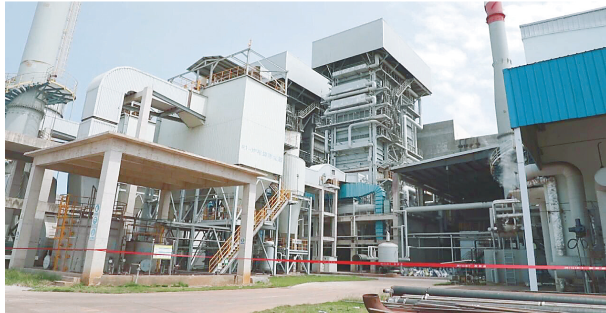
▲洋浦新奥泛能微网能源站。 洋浦电视台记者麦彦礼 陈文夏 摄
