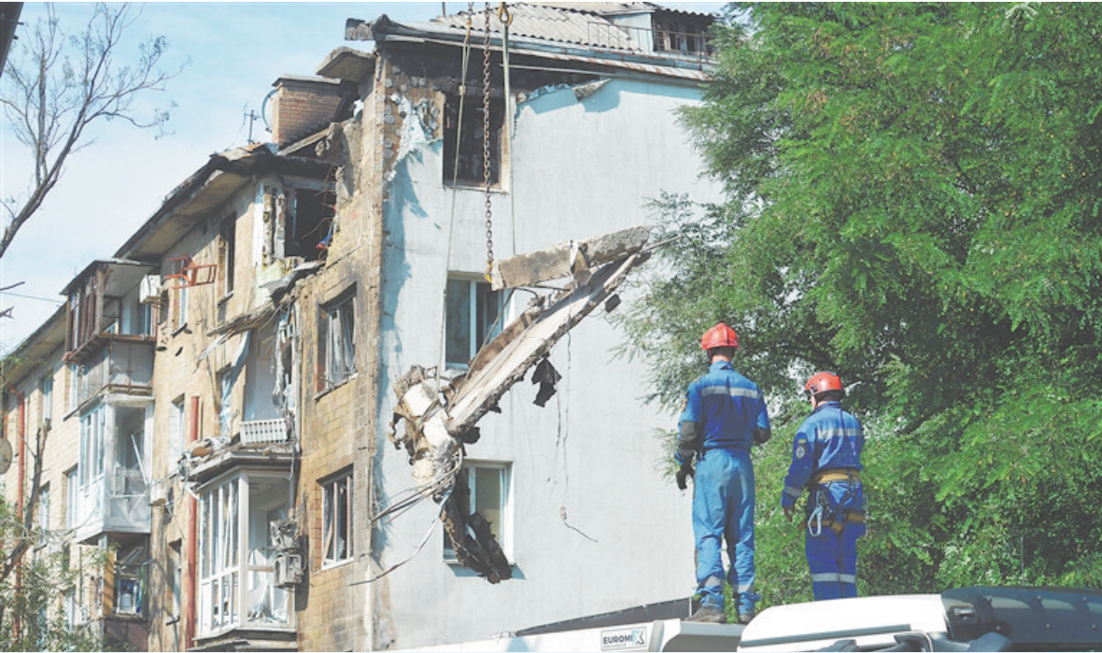
▲7月10日，乌克兰基辅市在空袭中受损的居民楼。 新华网 发
